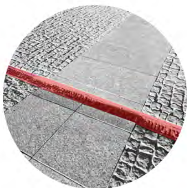
Fot. 1.3. Chodnik z płyt granitowych, został przerwany przez zagłębienie odpływu liniowego. Przerwanie ciągłości chodnika na odcinku oznaczonym symbolem M1.1.
