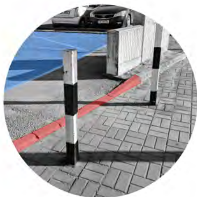
Fot. 3.6. Wąskie przejście z parkingu na plac przed UM. Zły stan techniczny krawężników.
