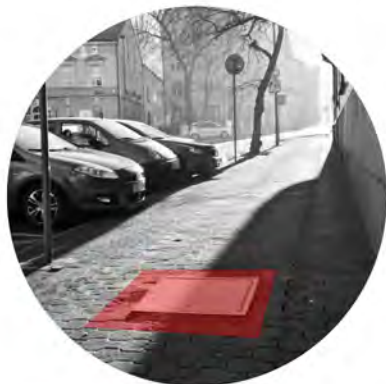
Fot. 2.1. Elementy infrastruktury technicznej umiejscowione na środku chodnika z wypunkleniem ponad nawierzchnię.
