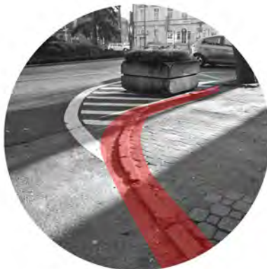
Fot. 2.2. Zły stan techniczny krawężników we wjazdach do wnętrza pomiędzy budynkami.
